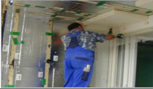
شكل (٩) الواح (VIP) بحوائط و سقف المبني {٣٣}.
